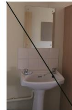
Плохо Раковина с пьедесталом. Фартук из плитки
